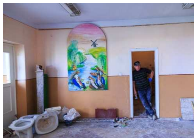
Будівельники на реконструкції приміщення сільської ради. Червень, 2017 рік Builders at the reconstruction of the village council premises. June 2017
