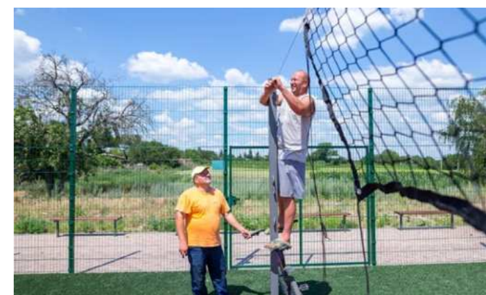
Облаштування волейбольного майданчика – тенісного корту. Липень, 2020 рік Installation of a volleyball/tennis court. July 2020
