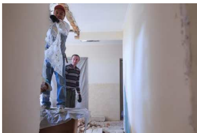
Реконструкція адмінбудівлі Великогаївської сільської ради. Червень, 2017 рік / Reconstruction of the administrative building of the Velyki Haii Village Council. June 2017
