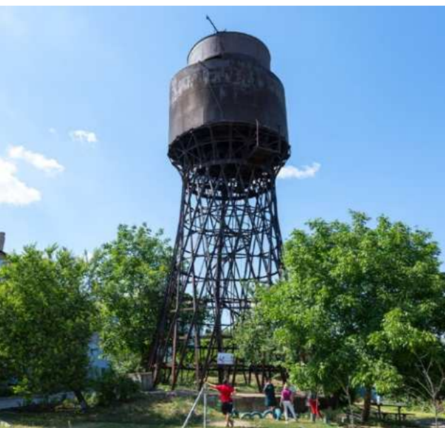
Водонапірна вежа В. Г. Шухова. Місто Помічна. Червень, 2020 рік Water tower designed by V.H.Shukhov. The city of Pomichna. June 2020
