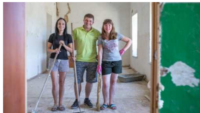
На фото зліва направо Марина Мазуркевич, Максим Тріщанович та Раїса Санько під час ремонту туристично-інформаційного центру. Село Станіслав. Липень, 2020 рік / From left to right: Maryna Mazurkevych, Maksym Trishchanovych and Raiisa Sanko during renovation of the tourist information center. Stanislav village. July 2020
