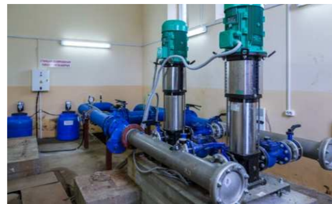
Насосна станція в селі Ракшівка. Червень, 2020 рік Pumping station in the village of Rashkivka. June 2020
