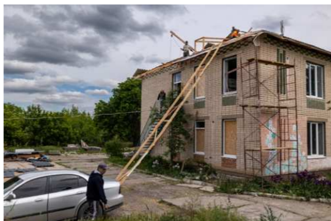
Відбудова Високопільського дитячого ясел-садка «Барвінок». Травень, 2024 рік Reconstruction of the "Barvinok" kindergarten in Vysokopillya. May 2024
