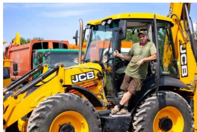
Микола Свірдков, оператор екскаватора, переданого Програмою USAID DOBRE комунальному підприємству. Липень, 2024 Mykola Sviridkov, an employee of a utility company, operating an excavator, procured by USAID DOBRE Program. July 2024
