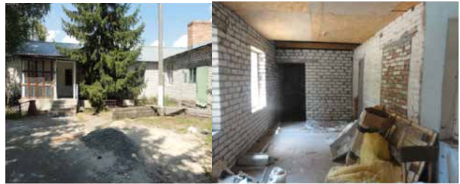
Проведення робіт з реконструкції амбулаторії загальної практики сімейної медицини з перебудовою покрівлі на ганку та будівництвом навісу над пандусом і входом в амбулаторію, Омелницька громада
