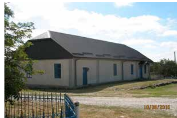
Капітальний ремонт шатрового даху сільського клубу по вул. І.Франка, 20-а с.Вільхівчик, Гусятинська ОТГ
