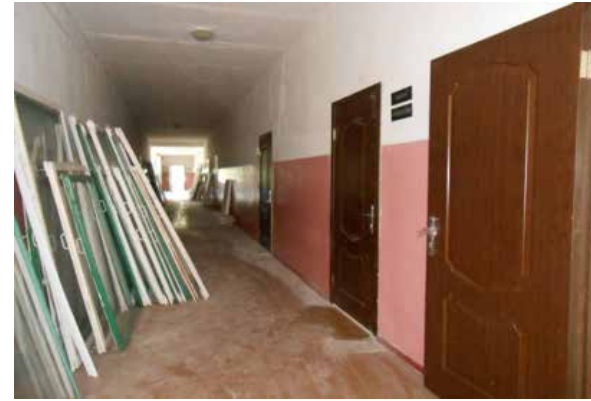
Капітальний ремонт, заміна вікон та дверей в ЗОШ с. Степове, Слобожанська (Ювілейна) ОТГ
