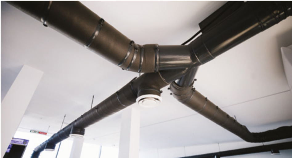
• Система вентиляції повітря у ЦНАП в Полонській ТГ
