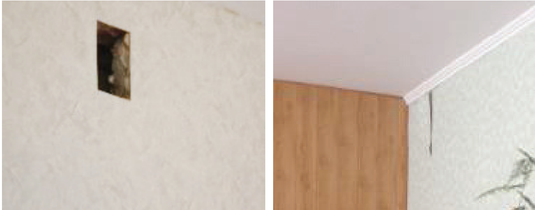
Рисунок 33: Відкриті (ліворуч) і закриті шпалерами (праворуч) вентиляційні канали. Джерело: Фотографії зроблено компанією Sweco під час виконання робіт, 2017 рік.
