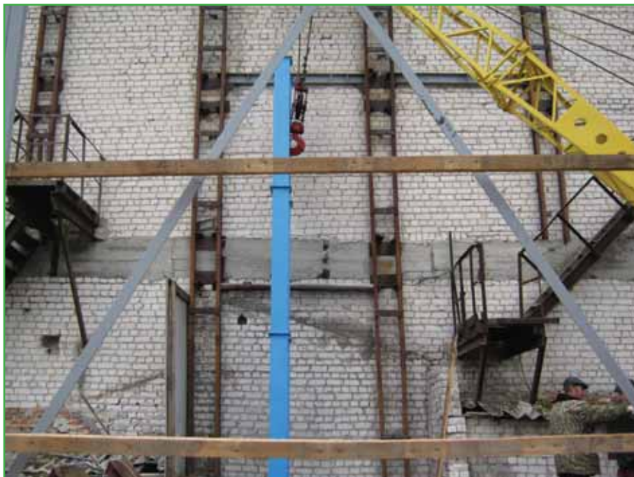
Будівництво млина на ПВТП «ДЖІ-ЕН-ЕЛ» в с. Горбове, Куликівського району, Чернігівської області
